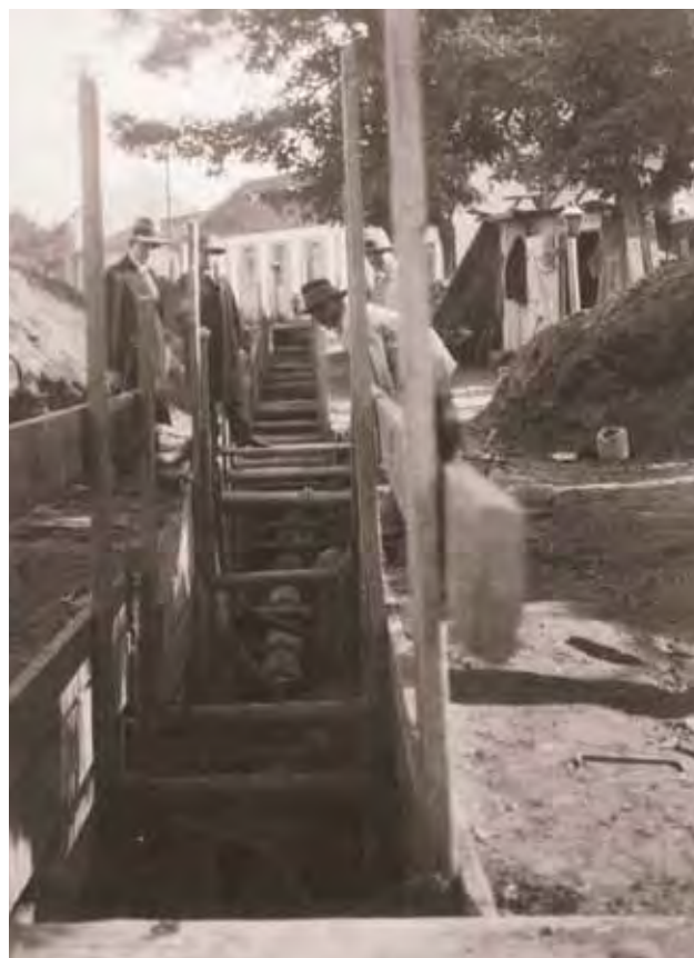
Rețeaua de alimentare cu apă, construită în 1914, a fost extinsă ulterior
