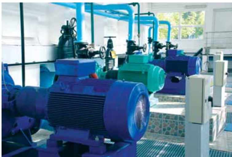
Stația de pompare de la Stația de tratare Urseni, modernizată în anul 2007
