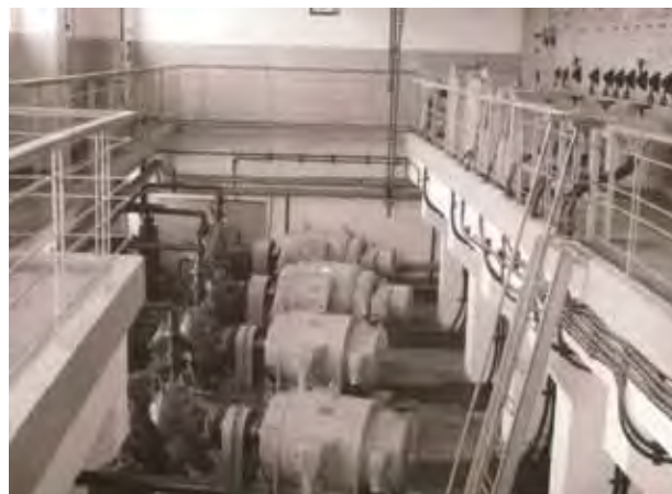
Pompe de distribuție – Uzina de apă nr. 2
